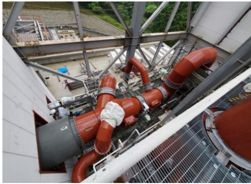
写真④ 炉室ダクト
