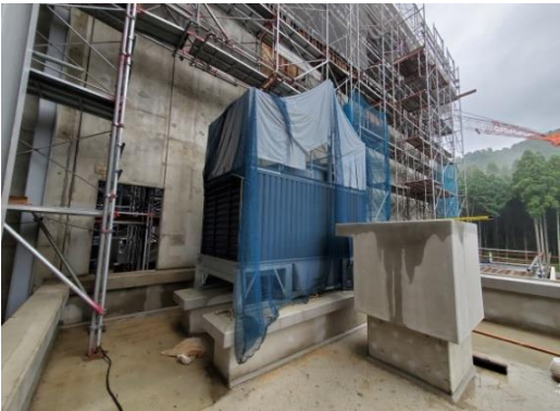
写真⑤ 機器冷却水冷却塔
