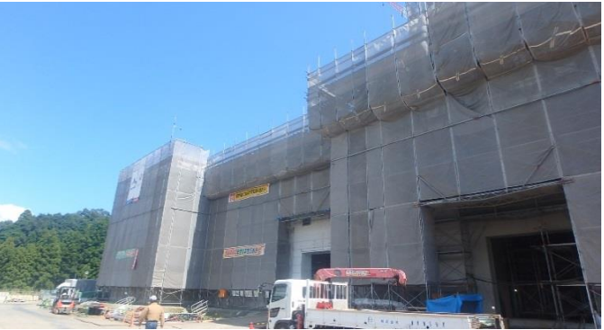
写真③ リサイクル～ごみピットエリア(北西から)
