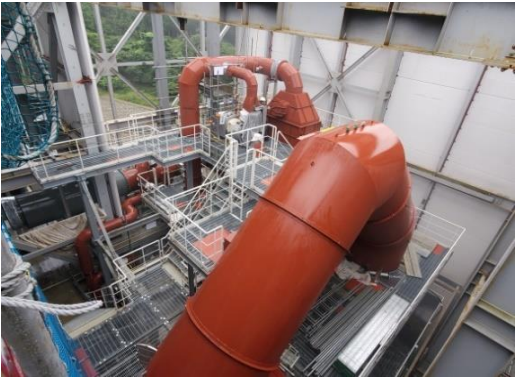
写真① 焼却炉架台・歩廊
