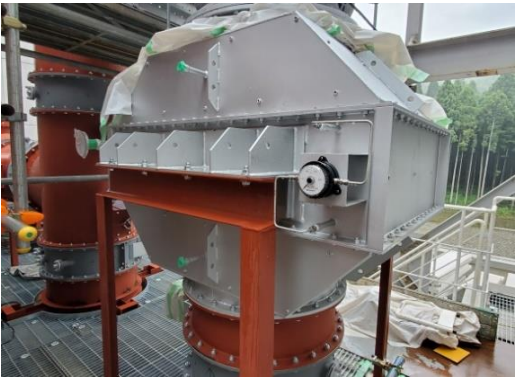
写真③ 温水発生装置
