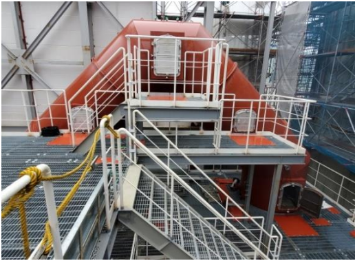
写真② ガス冷却室・再燃焼室
